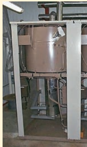
Abb. 22 Seit 1991 in Betrieb: Solare Kühlung eines Weinflaschenlagers in Banyuls in Südfrankreich. Zwei Absorptionskälteanlagen mit zusammen 52 kW Nennkälteleistung kühlen ca. 3.500 m 2 Lagerfläche. Durch die thermische Trägheit des Flaschenlagers ist ein Kältespeicher nicht notwendig. Die Anlage wird über ein Vakuumröhren-Kollektorfeld angetrieben; ein Backup-System existiert nicht. Quelle: Tecsol, FR
