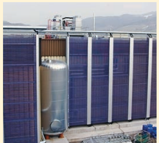
Abb. 30 Solare Kühlung Großmarkthalle Oberkirch Quelle: p-power GmbH
