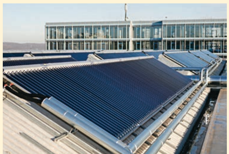
Abb. 23 oben: seit 2001/2007 in Betrieb: Solar unterstützte Klimatisierung des Technologie-Centers der Fa. FESTO AG & Co. KG. Links ist eine der drei Adsorptionskälteanlagen mit je 350 kW Nennkälteleistung zu sehen Quelle: Fraunhofer ISE
