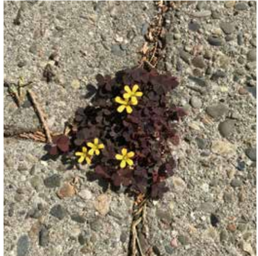
Abb. 130: Allen Pflasertypen gemeinsam sind die Fugen zwischen den Pflastersteinen. Hier bewachsen mit Horn-Sauerklee ( Oxalis corniculata ).
